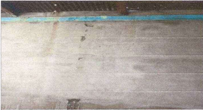
Foto7: Pintura en el área de cocina
